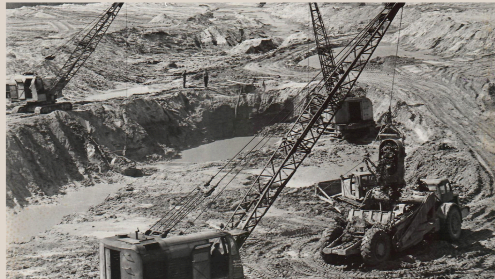
Выемка грунта в котловане для водонасосной станции № 1 на строительстве сооружений Вилейско-Минской водной системы, которую ведет коллектив СУ-1 Вилия-Минскводострой. 24 июня 1970 года
